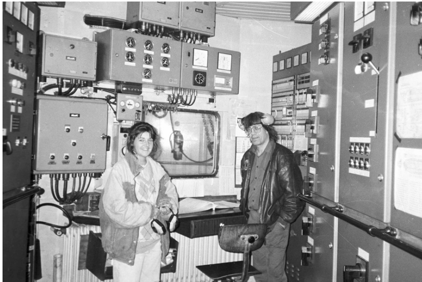
Avec Thor, le chef mécanicien, dans la salle des machines
